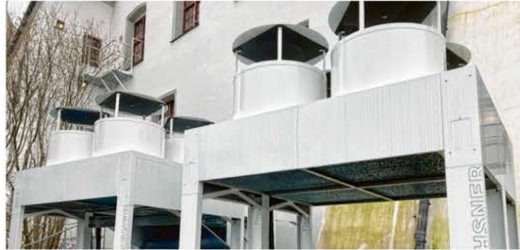
Versteckt hinter Büschen und Bäumen sind die Außenelemente der Wärmepumpe installiert worden. Foto: Karen Annemaier
